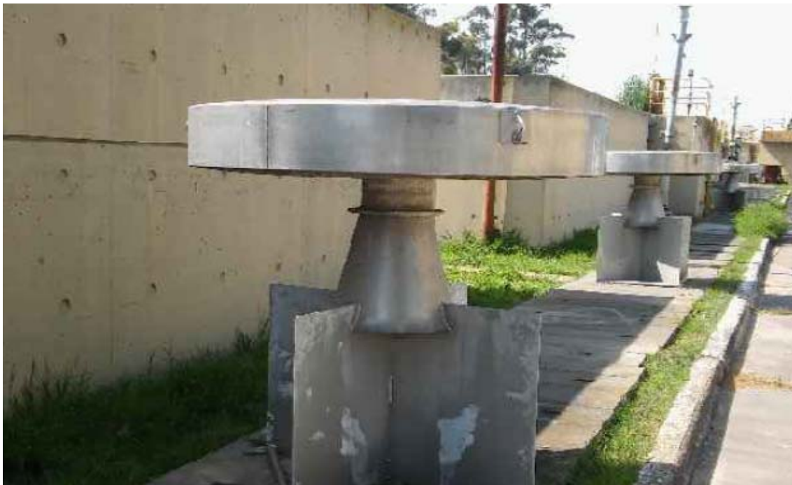
Sopladores fuera de funcionamiento
