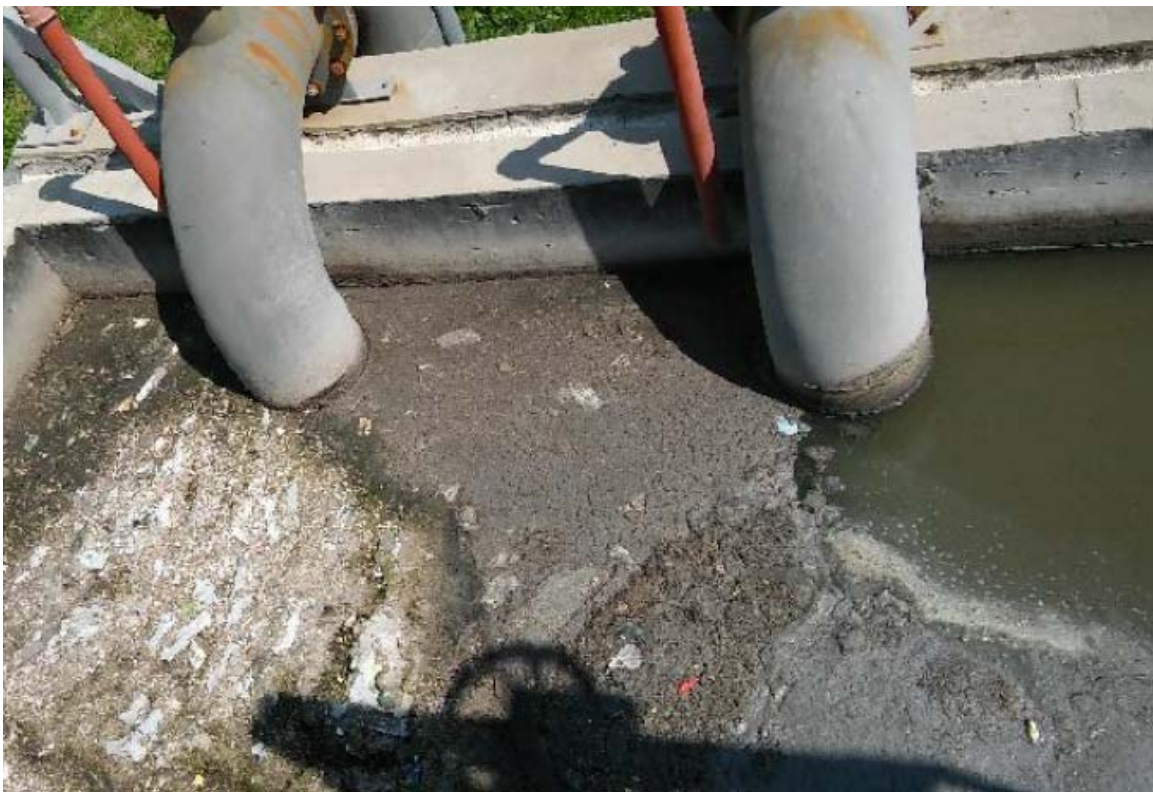
Desarenador con líquido cloacal y flotantes
