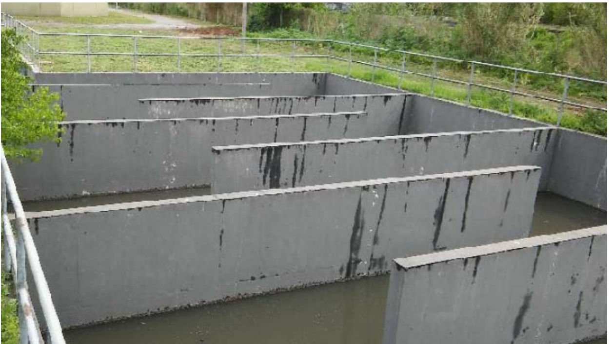
Figura 15: Cámara de contacto. Vegetación muy cercana a las instalaciones.
