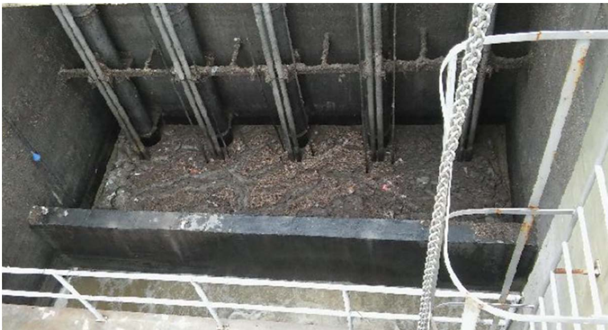
Figura 10: Barros y flotantes en Estación de Bombeo de llegada
