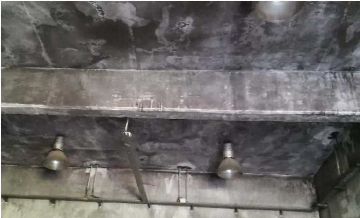
Techo quemado en depósito
